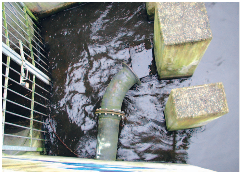
Für die Regenwasserkanäle sind die Kommunen zuständig. Abwasser und Regenwasser dürfen nicht vermischt werden, verlangt der Gesetzgeber. Regenwassereinleitung am Teltowkanal.
