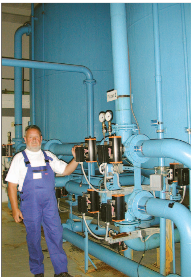
Im Wasserwerk Kleinmachnow: wird Eisen und Mangan ausgefiltert.
