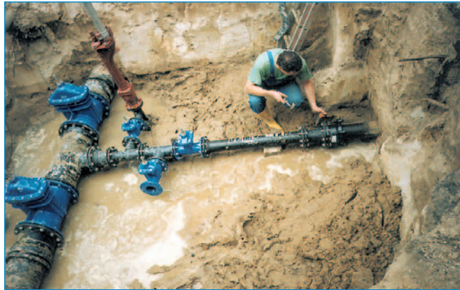
Fachmännische Anschlussarbeiten für die Wasser- und Entsorgung auf einem Baugrundstück. Foto: MWA
