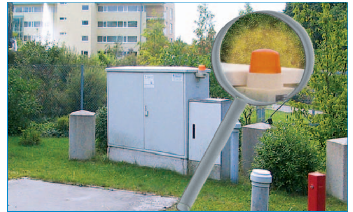
Unscheinbar ist solch eine Pumpstation, doch blinkt die seitlich montierte Warnlampe, ist höchste Aufmerksamkeit gefordert. Foto: MWA
