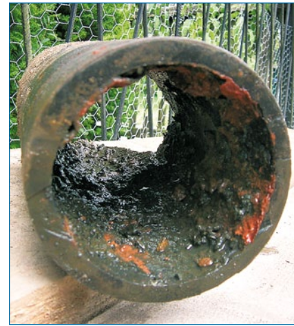
Rohre, die über 40 und teilweise sogar bis zu 100 Jahre genutzt wurden, müssen wegen der Innenwandablagerungen unbedingt ausgetauscht werden.
