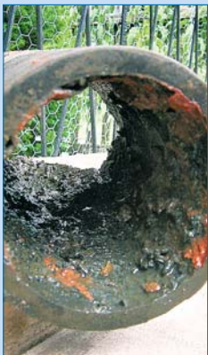
Im Laufe der Zeit bilden sich Inkrustationen in den Trinkwasserrohren, die durch jährliche Spülungen beseitigt werden.
