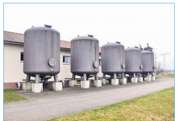
Kiesfilter im Wasserwerk Teltow. Das Werk in der Ruhlsdorfer Straße fördert jährlich zwei Millionen Kubikmeter Wasser. Zusammen mit dem Wasserwerk Kleinmachnow werden über diese beiden Anlagen ca. 60.000 Einwohner des Verbandsgebietes „Der Teltow“ versorgt.
