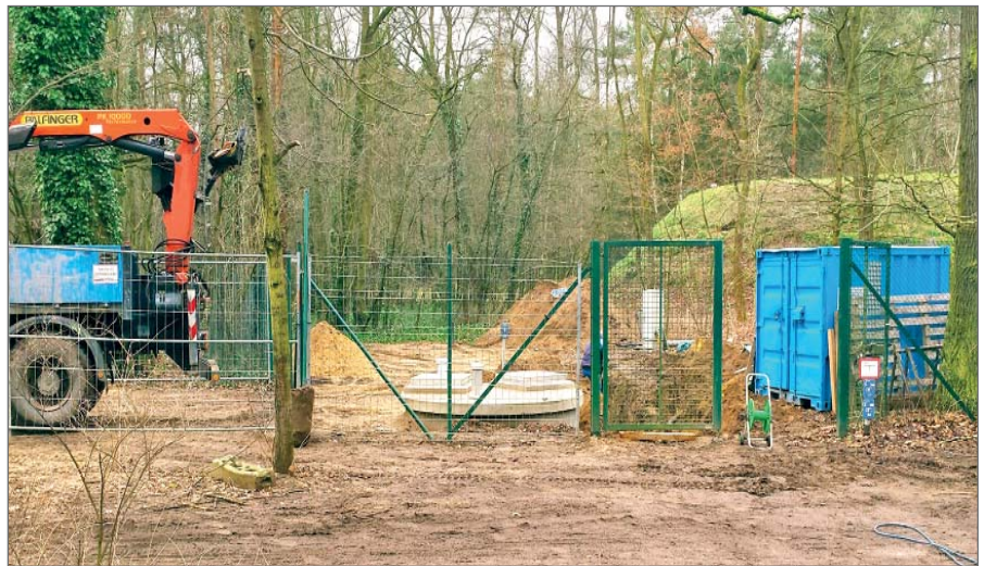
Wasserwerk Kleinmachnow, neuer Brunnen 3
