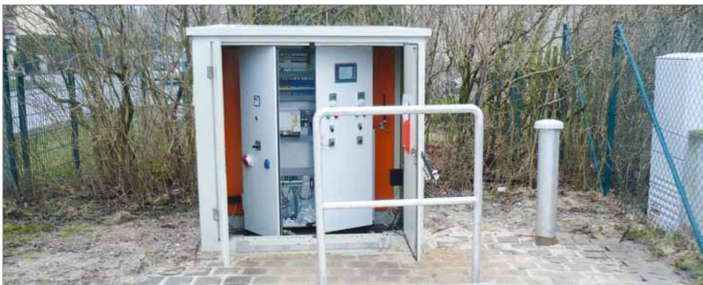
Moderne Technik vor Ort hilft, die Funktionsfähigkeit der Anlagen vom PC aus zu überwachen.
