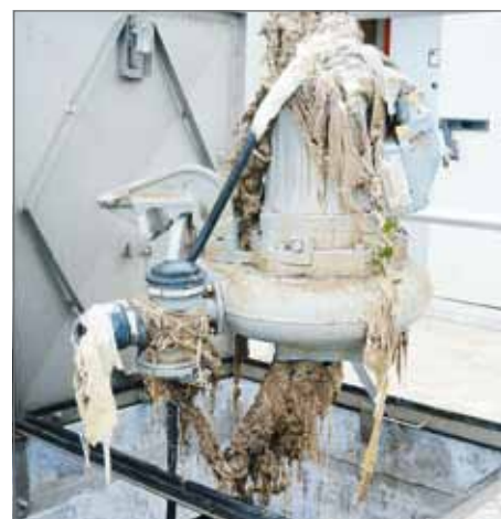
Verstopfte Abwasserpumpe Fotos: MWA
