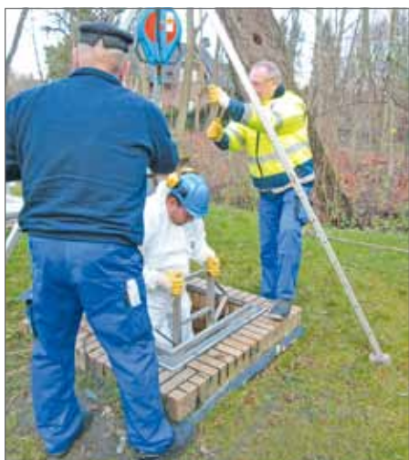
MWA-Mitarbeiter bei der Wartung.
