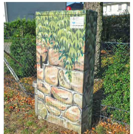
Am Güterfelder Damm in Stahnsdorf arbeitet mit einer Leistung von 300 m 3 /Jahr die „kleinste“ Station.
