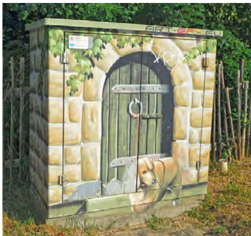
Vorsicht bissiger Hund? Nein! Unsere Abwasser-Pumpstation in der Bergstr. Stahnsdorf (75.000 m 3 /Jahr).
