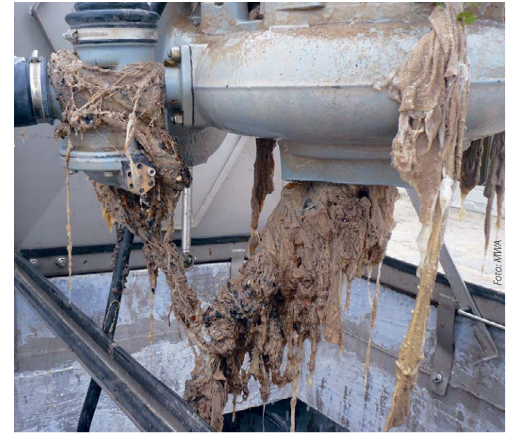
Verzopfungen wie hier im Bild legen über kurz oder lang die stärkste Pumpe lahm.
